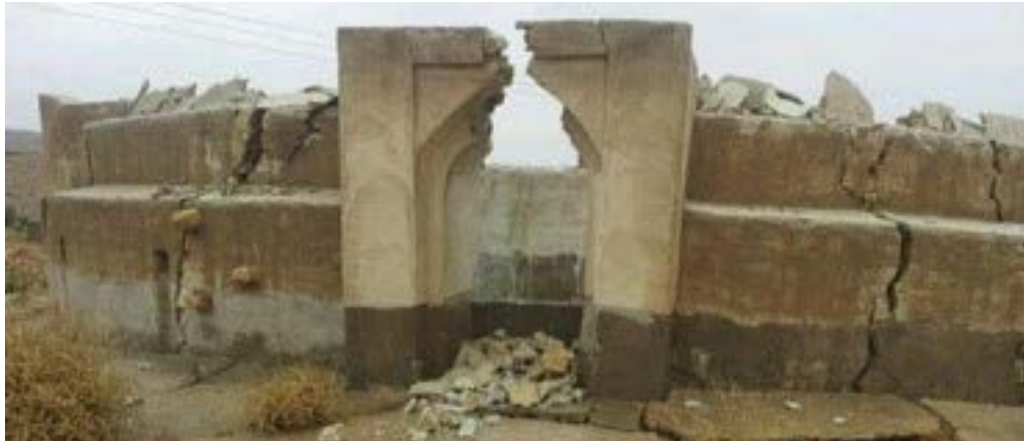
تصویر ۶. تخریب یکی از برکه‌ها به دلیل عدم رسیدگی (عصر لارستان، ۱۳۹۵).
